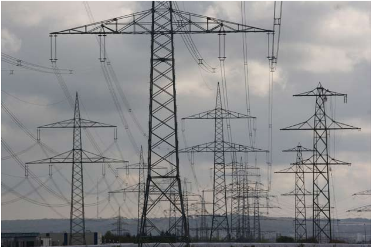
Blick auf die Stromtrasse in Bornheim
